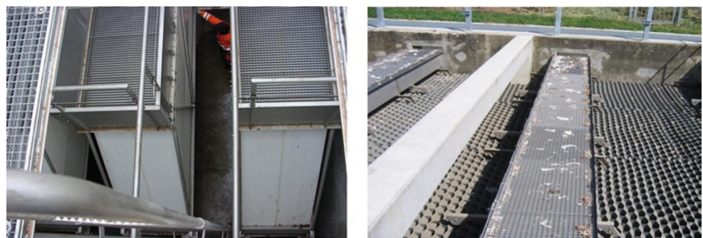
Abb. 4 Schrägklärelemente in einem Regenklärbecken ( links ) und einem Regenüberlaufbecken ( rechts )
